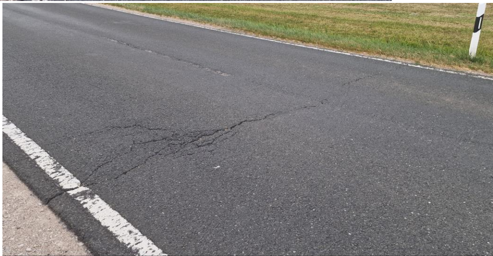
Beispiele Fahrbahnrisse FÜ 8
