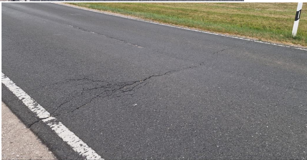
Beispiele Fahrbahnrisse FÜ 8
